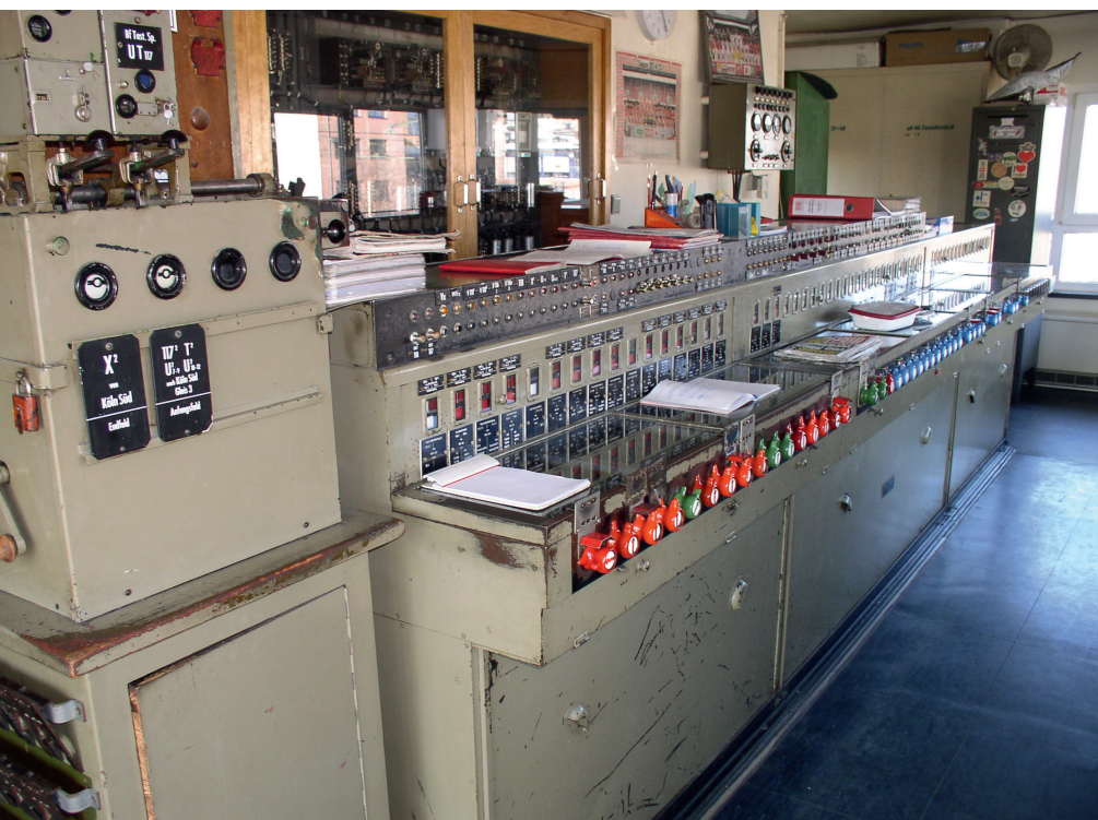
Abb. 1: Stellwerk WS in Köln West
